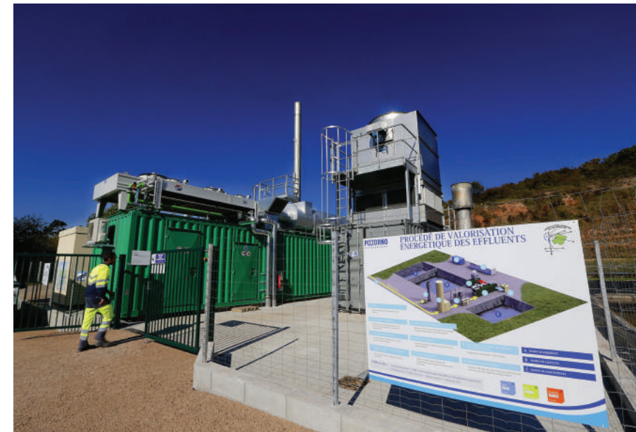
Unité de cogénération
