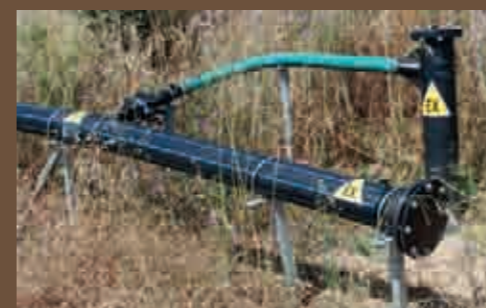
Puit à biogaz.
