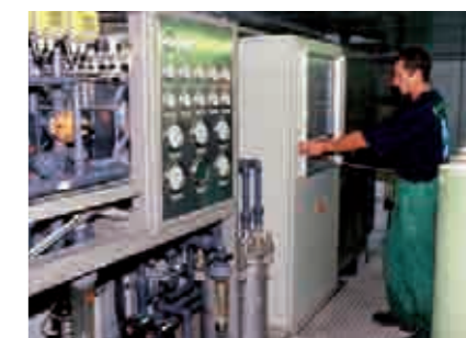
Contrôle des lixiviats.
